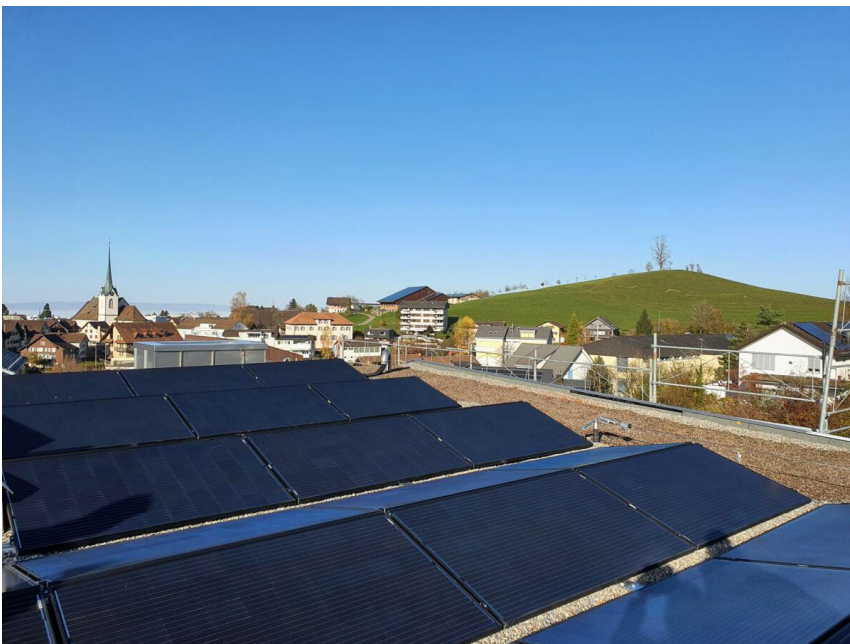
Photovoltaikanlage „Luegeten“, Menzingen
